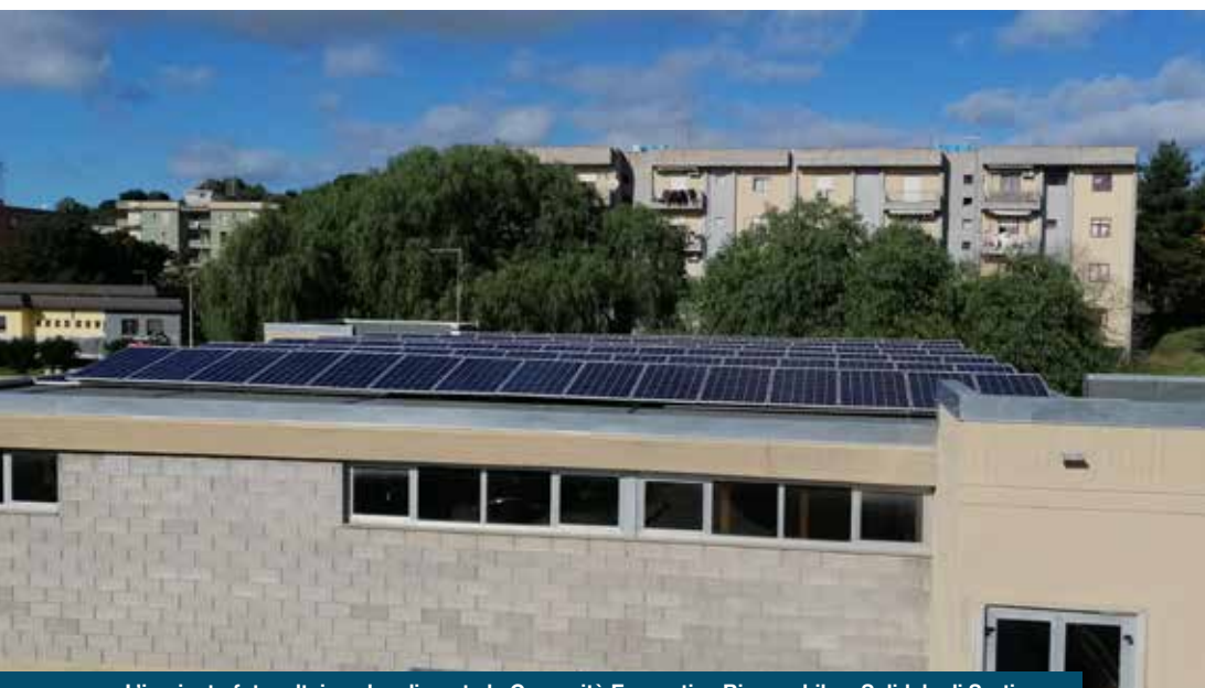
L'impianto fotovoltaico che alimenta la Comunità Energetica Rinnovabile e Solidale di Sortino
