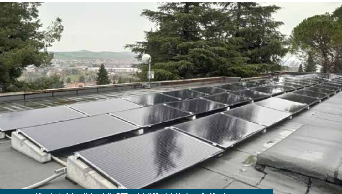
L'impianto fotovoltaico della CERossini di Montelabbate, nelle Marche
