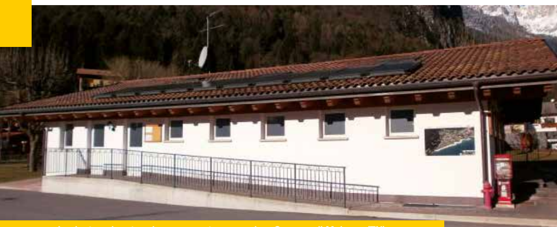
Impianto solare termico su copertura camping, Comune di Molveno (TN)
